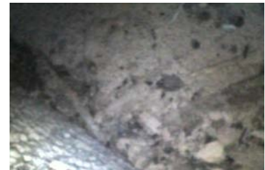
Abb 15 Mäusekot in dem Zwischenboden. Diese sind kompakter und stumpfer als Kotkrümel von Fledermäusen (Ansicht mit der Endoskopkamera).
