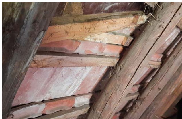
Abb. 12: Bereich des Dachbodens, welcher nicht isoliert ist und damit potenzielle Spaltenquartiere aufweist.
