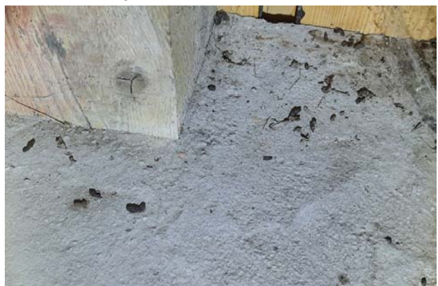
Abb. 21: Mäusekot am Boden des Schuppens.
