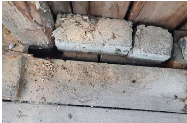
Abb. 14: Spalten als möglicher Zugang zum Zwischenboden.
